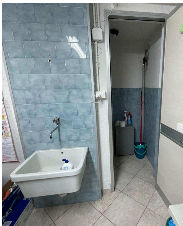
Punto acqua e ingresso servizio igienico piano interrato
